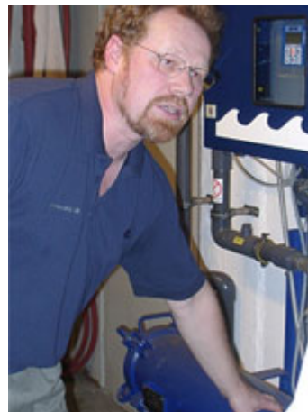
Hal-inspektør Jørgen Mosbæk forklarer, hvordan Vestbadets enestående regnvands-anlæg på Vestbadet fungerer. Mange interesserede fra nær og fjern har været en tur forbi.
