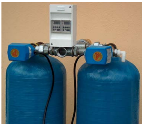
Tvilling filteranlæg med automatisk returskyld
